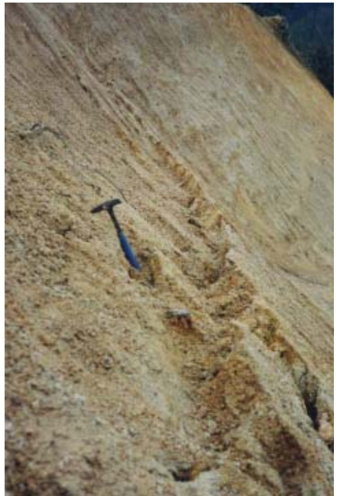
写真-1 膨潤性粘土の法面変状
