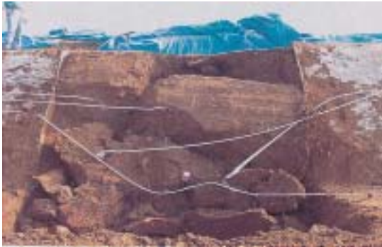
写真-8 フィールドテスト状況(盛土崩壊)
