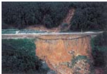
写真-2 盛土崩壊および施工基面までの土砂流入
