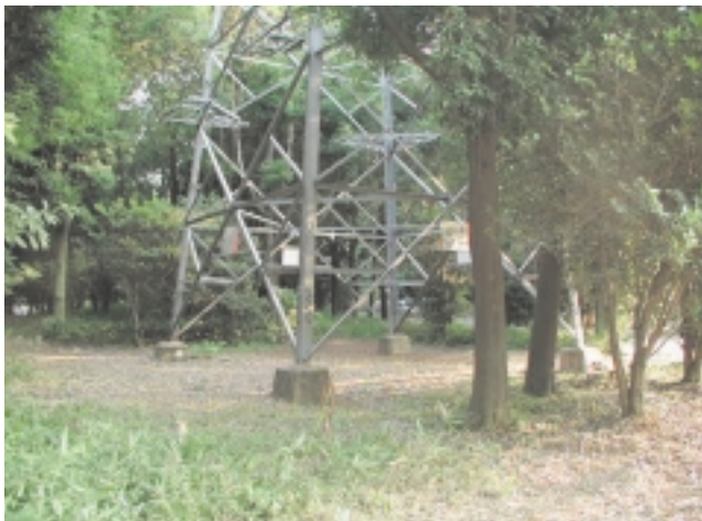
写真-1 学園中線No.6鉄塔
