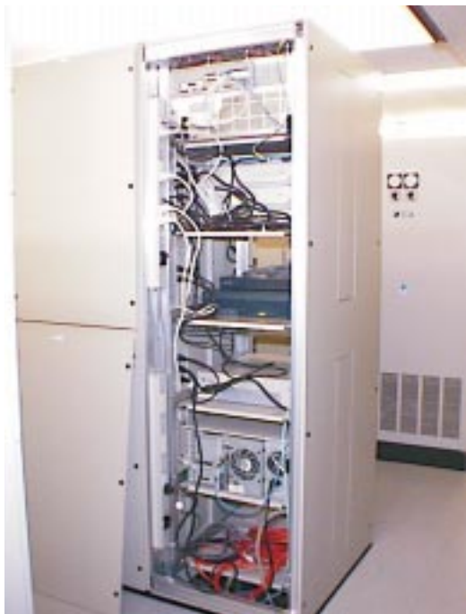
図 - 4 ハウジング機器設置状況
