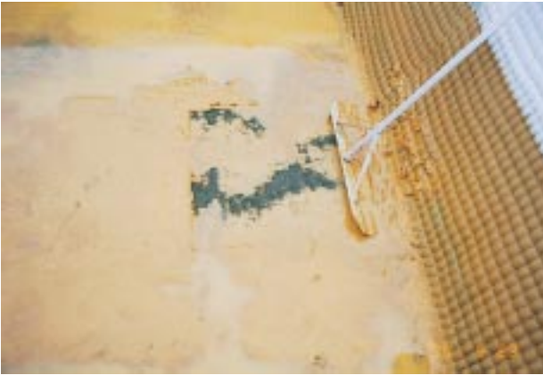
写真 - 8 ろ過池内に蓄積した鉄バクテリアとその除去状況
