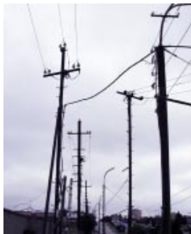
バクー市既設配電線
