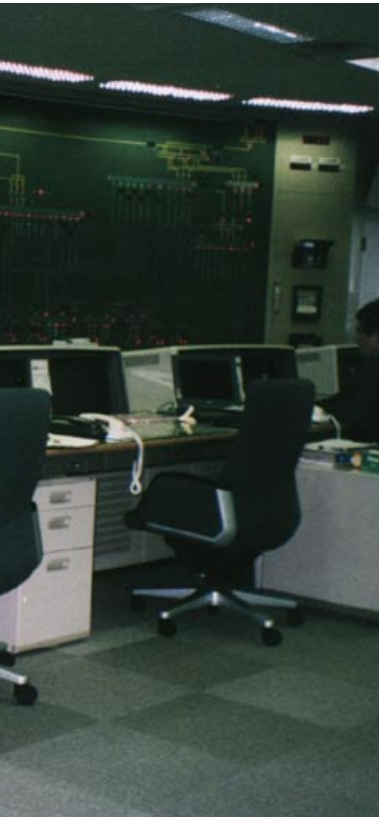
給電所制御室
