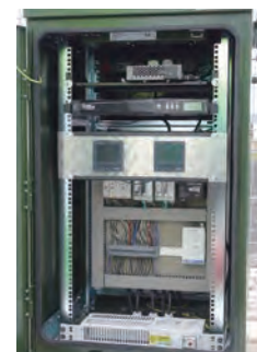
蓄電池制御システム
