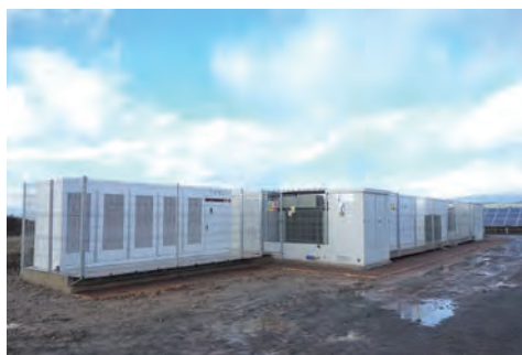
4MW蓄電池全景
