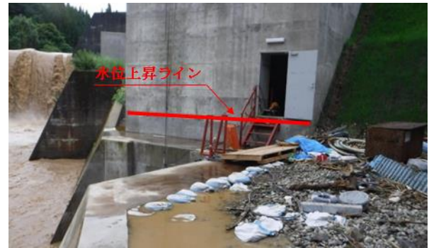
写真-4 2020年7月28日洪水被害状況
