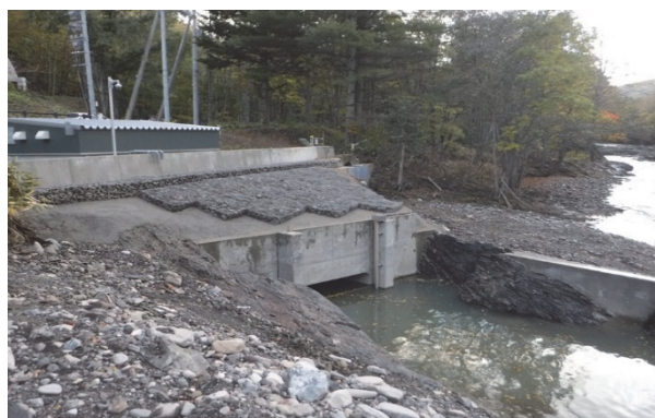
写真－３ 放水路護岸洗堀状況（上）と復旧状況（下）
