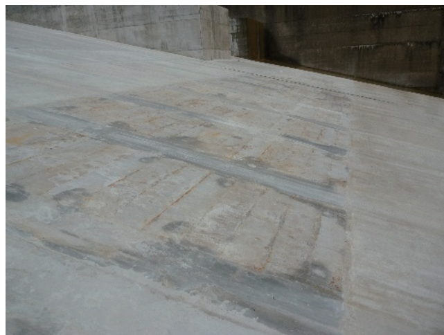
写真-9 スロットジョイント表面部の状況
