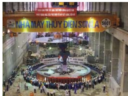
発電機（回転子）、天井クレーン
