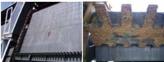
写真 2 C 排水機場 除塵設備劣化状況
