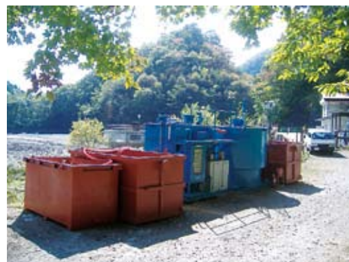
濁水処理設備
