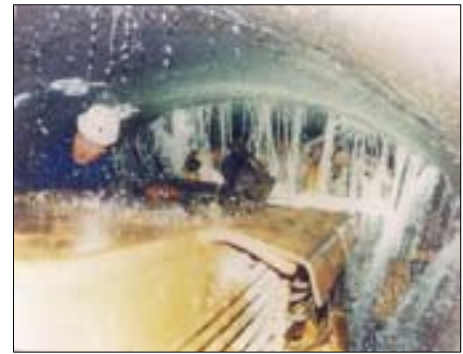
トンネル内湧水状況
