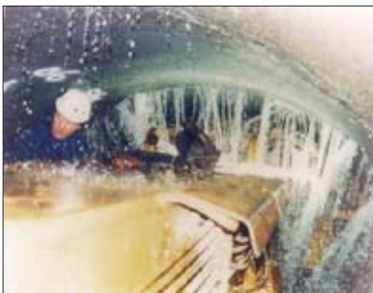
写真-3 トンネル内湧水状況
