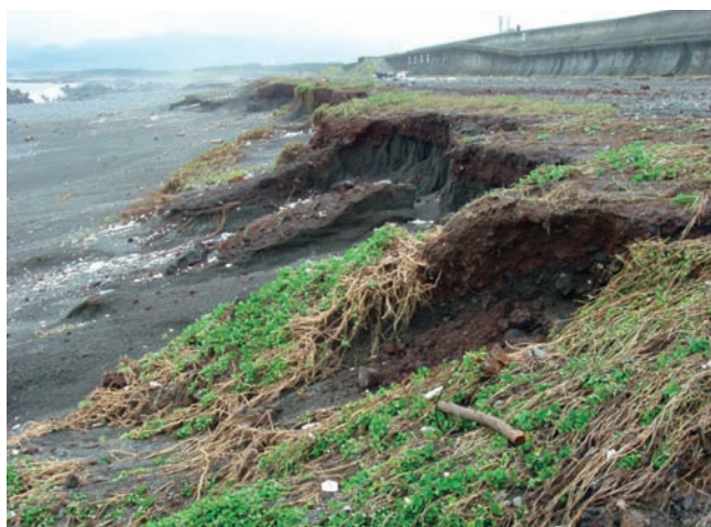
富士海岸における台風来襲後の浜崖の形成状況 (富士海岸吉原工区)
