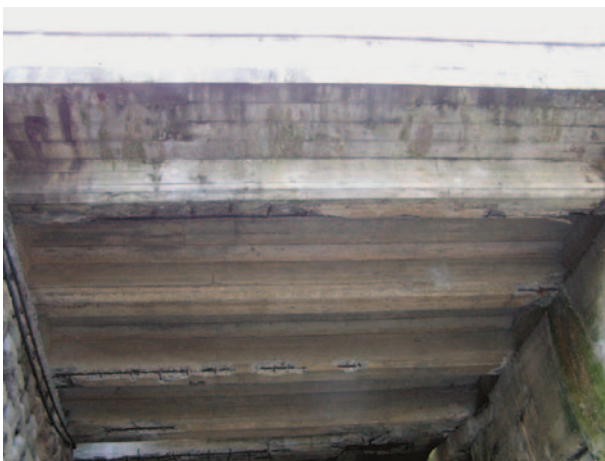
写真-3 橋梁上部工下面の劣化状況
