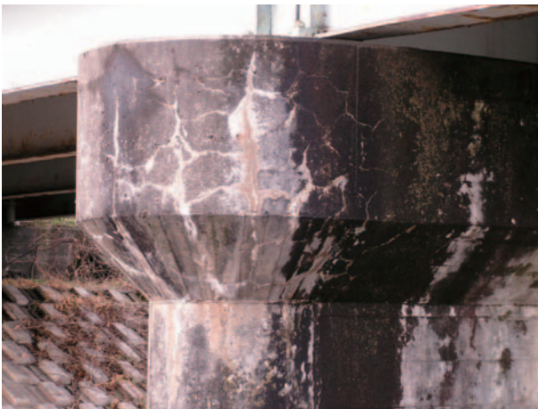
写真-5 橋脚張出し部の劣化状況
