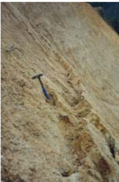
膨潤性粘土による法面変状
