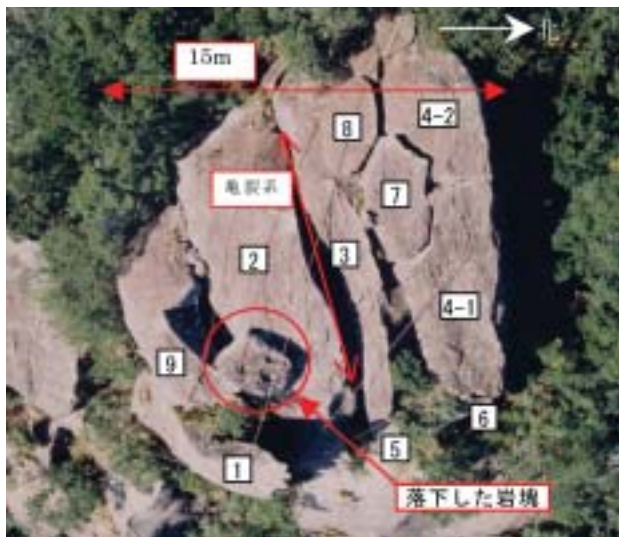
写真-2 不安定岩塊(上空より)
