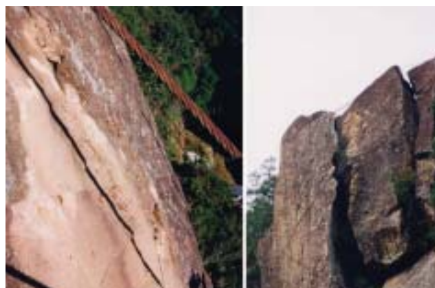
写真一7 発生位置での落石と斜面の接触
