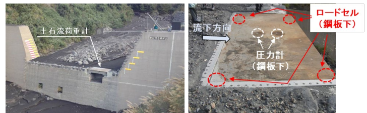
写真-2 桜島有村川に設置されている土石流荷重計
