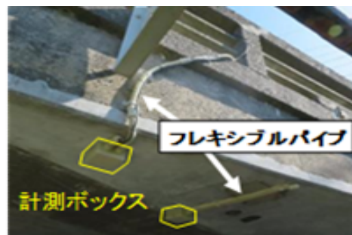
センサ・ケーブル・計測ボックス設置例
