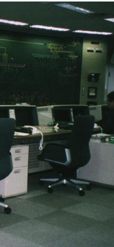
給電所制御室
