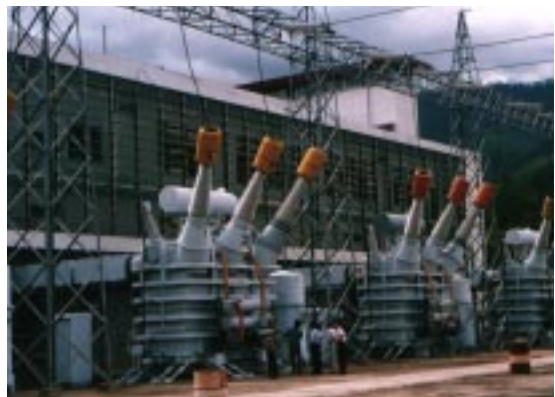
発電所内の主変圧器
