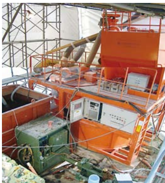
写真-3 全自動プラント
