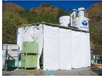
写真-4 グラウトプラント外観
