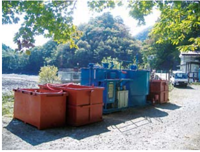
写真-6 濁水処理設備
