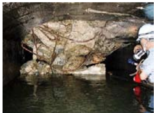
図-1 崩落した水路トンネル
