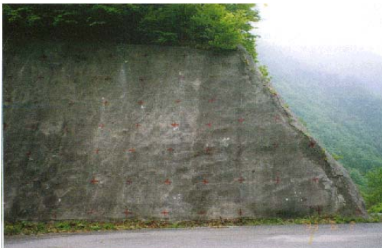
図-2 老朽化した吹付のり面
