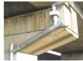
③梁部の上部で鉄筋の拘束を受けた水平方向のひび割れが発生することがある。
