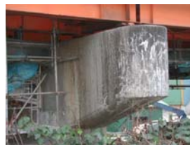
①張出し部で降雨や路面排水がかかる箇所に亀甲状のひび割れやゲルのしみ出しが発生しやすい。
